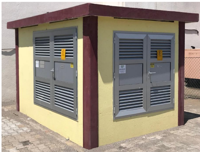
Slika br. 7. Primjer građevinskog objekta trafostanice sa spoljašnjom manipulacijom
