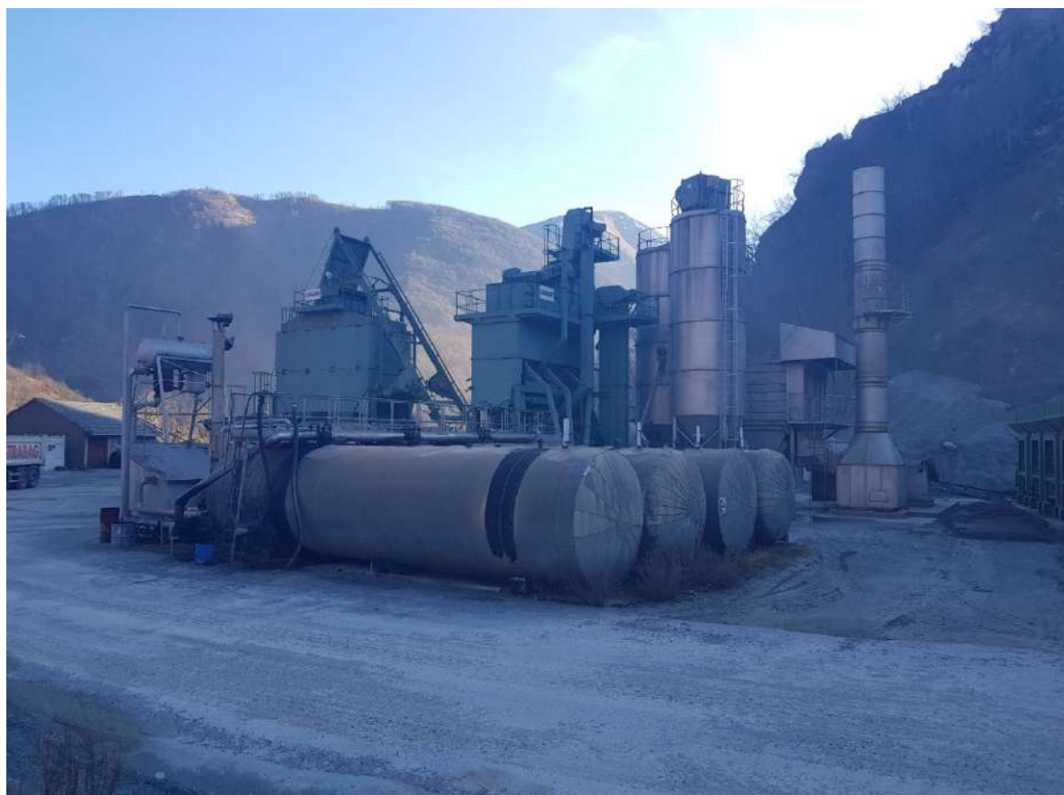
Slika 11. Izgled postojećeg Postrojenja za proizvodnju asfalta – asfaltna baza, tipa VIBAU
